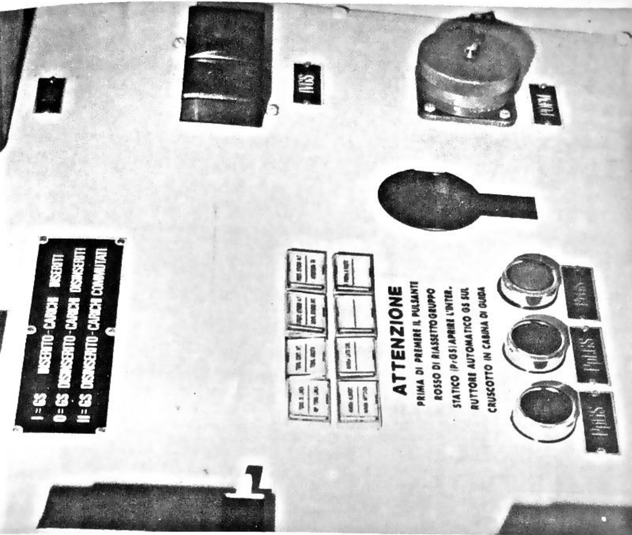
FIG.5 - Disp. L.Sp. del C.S. e pulsanti, in corridoio.
